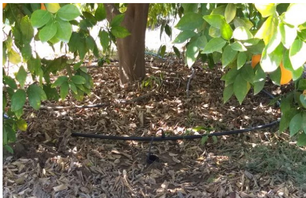
شکل ۲- سامانه آبیاری زیرسطحی عمقی
